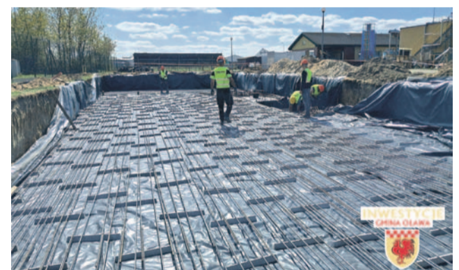
Oczyszczalnia ścieków w Stanowicach
